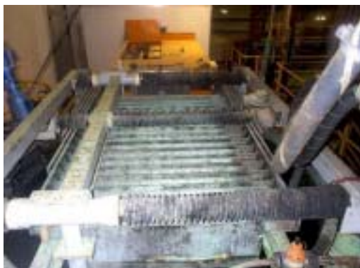
图 7 使用英泰克工艺的示范厂满负荷生产中的电解槽 (照片前方) 和整流器 (照片后方)
