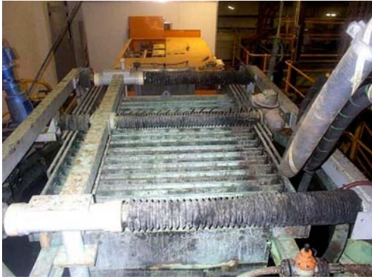
Figura 7: Celda de electro-deposición (adelante) y el rectificador (fondo) en producción completa en la planta de demostración del Proceso de Cobre Intec.
